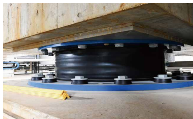
図1 東京工業大学すずかけ台キャンパスJ2棟の基礎部分に設置された免震ゴム装置。この他にも免震ダンパーやセンサー、地震計などあらゆる装置が導入され、都市地震工学の粋を集めた建築となっている。
