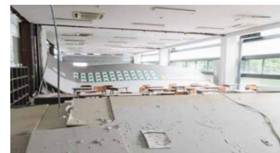
図5 熊本地震の揺れによって教室を仕切る壁が倒壊。吉敷さんの調査によって、この学校の構造は損傷していないことがわかったが、建て替えられることになった。
